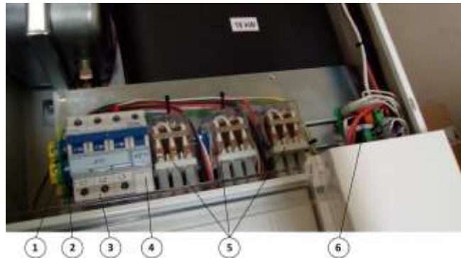
Pogled na sklopnički blok
